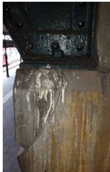
10. Breukschade bij de oplegging spant hoge kap op natuurstenen console.
