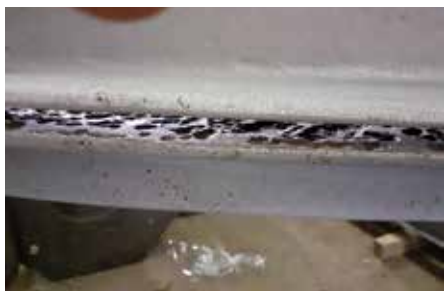
12. De tussenruimte van de profielenparen is door putcorrosie aangetast (situatie na stralen).
