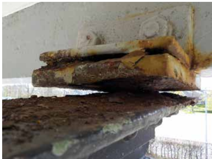
19. Voorbeeld gecorrodeerde verbinding door het ontbreken van bouten.
