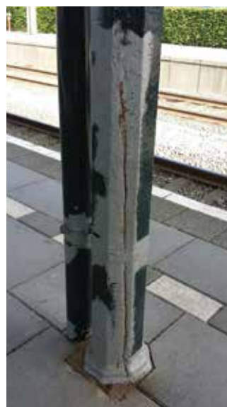
7. Vorstschade en een 'noodoverloop'.
