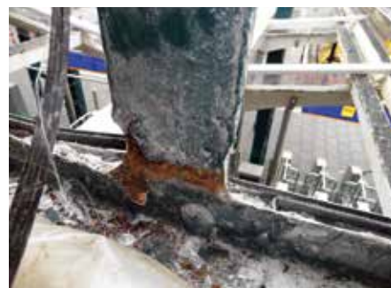
14. Voorbeeld gecorrodeerde verbinding Westgevel.
