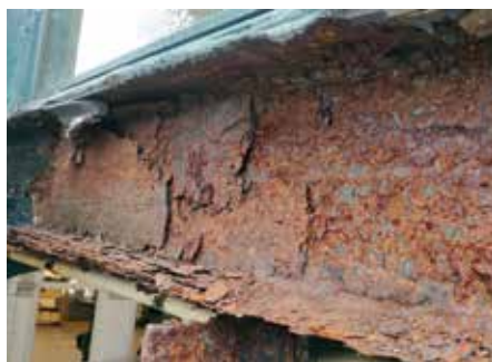
13. Corrosie onderrand van de Westgevel.
