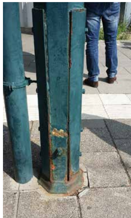
16. Gebroken kolom door verzetsdaad (zie p. 24).
